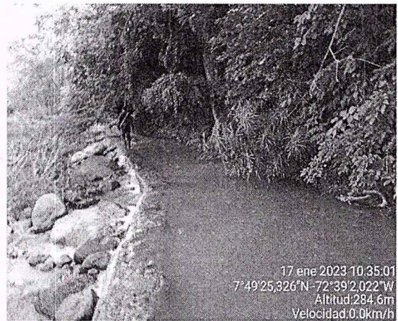
desborde de exceso
