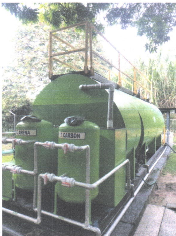
FOTOGRAFÍA 2. TANQUES DE AIREACIÓN
